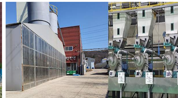
동원에너지 폐기물 연료화 시설 전경 / 연료탄 성형설비
